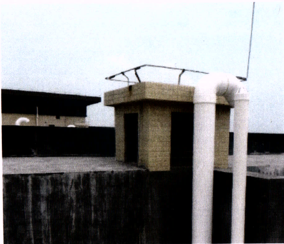
图 8-3 燃油废气排放口
